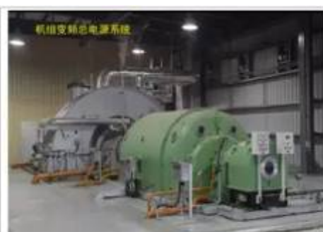
图 3. 纯凝式、自带凝汽器 SIEMENS 制造的 21MW 汽轮机 配置北重制造的空冷式 30MW 发电机
